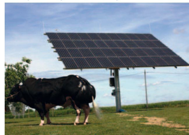
Suiveur photovoltaïque du Tersoit - Ciney
