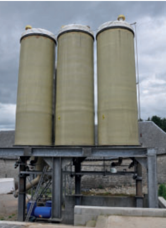
Les infrastructures permettent le stockage d'aliments secs, humides et liquides (mélasse et vinasse).
